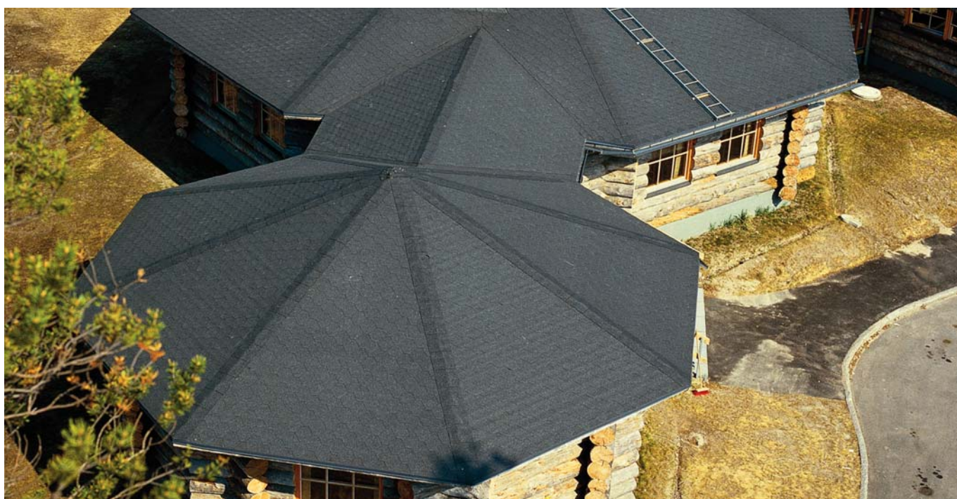
En spännande takutformning med många vinklar. Inga problem att lägga Shingel här heller.
