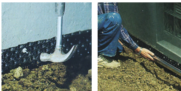
Bild 7A och B. Fuktspärren spikas i övre kant och avslutas med putsbeslag eller kantlist.
